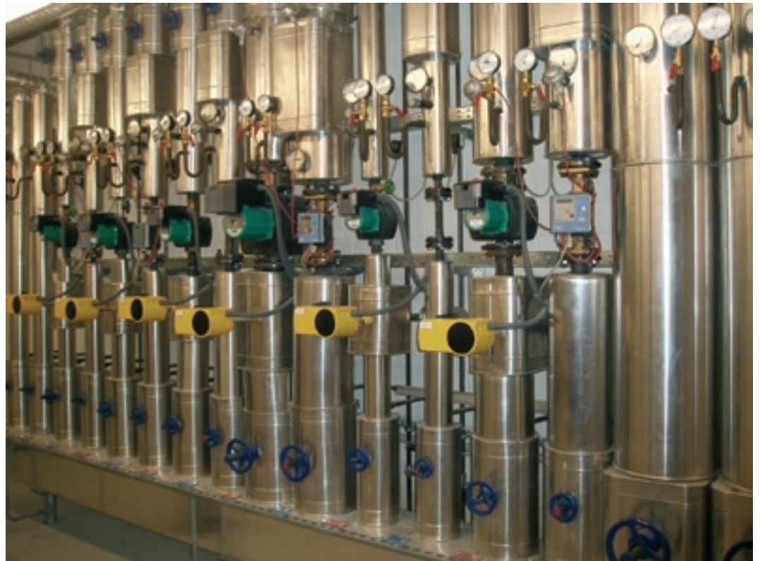
Fernwärmeübergabestelle mit digitaler Verbrauchsabmessung
